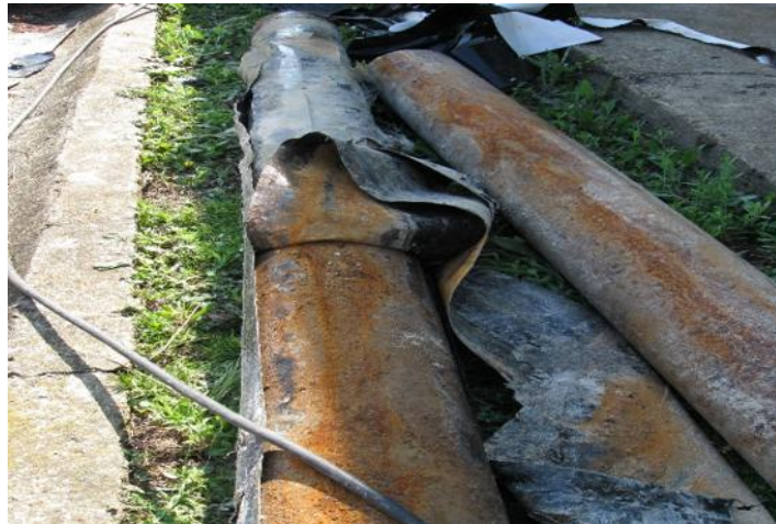
Loše izvedena pasivna AKZ ukopanog čeličnog cevovoda.
