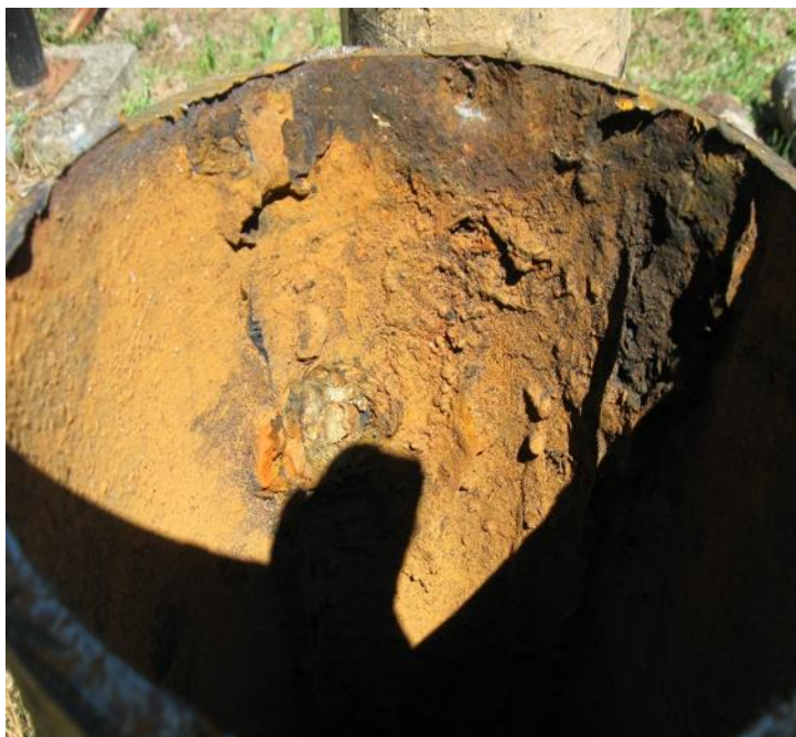
Unutrašnjost čeličnog cevovoda sa unutrašnjom korozijom.
