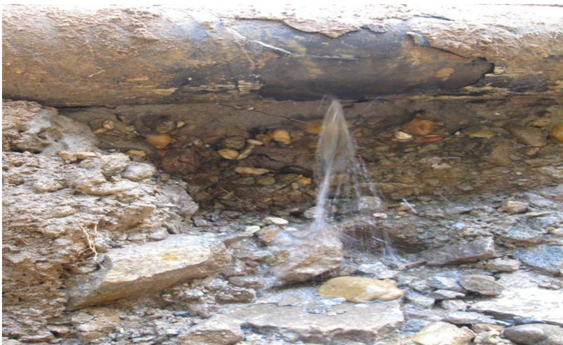
Najveći broj perforacija sa donje strane na ukopanom čeličnom cevovodu za transport derivata nafte.
