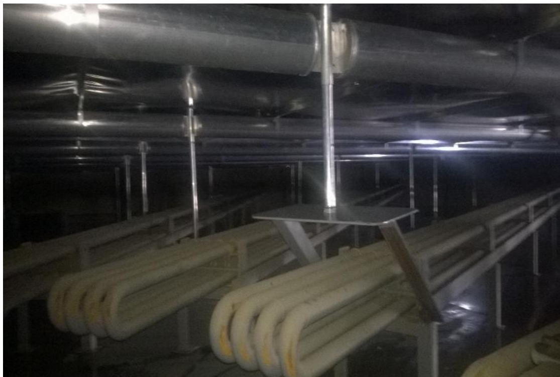
Unutrašnjost rezervoara od 20.000 m 3 za skladištenje sirove nafte – ispod plivajuće membrane.
