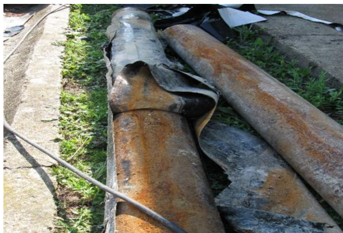
Loše izvedena pasivna AKZ ukopanog čeličnog cevovoda.
